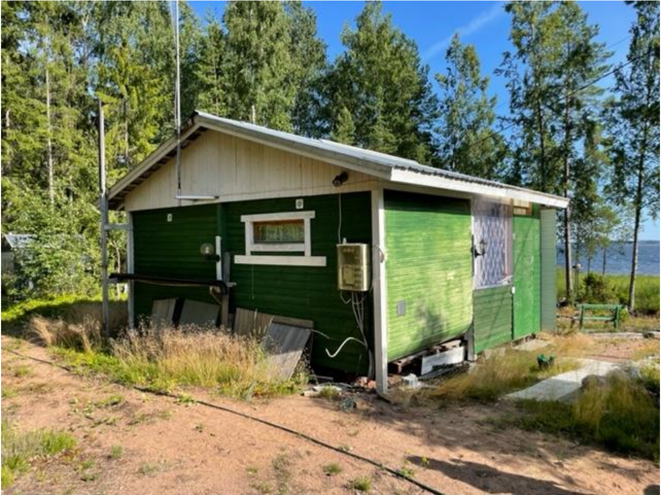
Bild 5, fritidsbostaden som är i dåligt skick på området.
