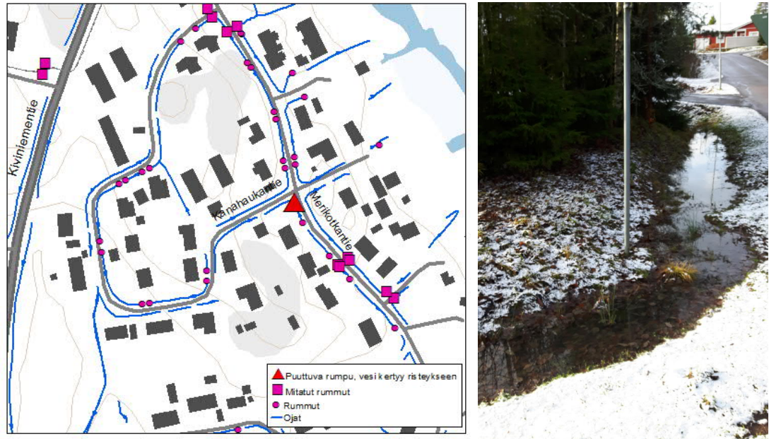
Kuva 13. Sijainti, jossa vesi kerääntyy ojaan rummun puuttuessa.
