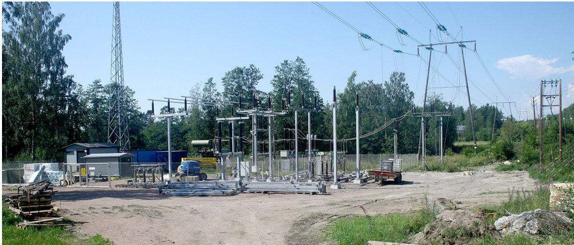
Alueella sijaitseva muuntamoalue, jonka ympäristö kaippaa jäsennystä.
